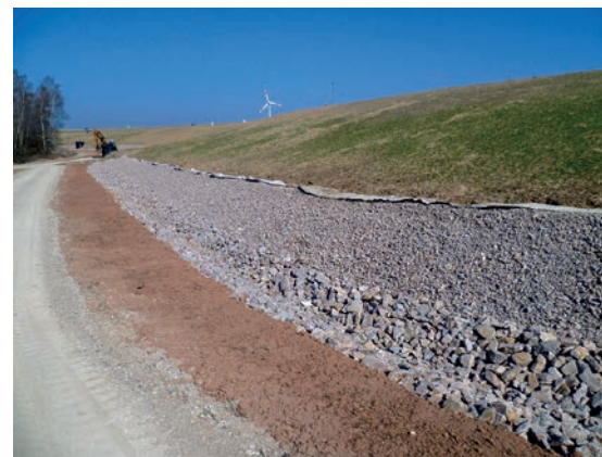
Den Folgen des Altbergbaus soll entgegengewirkt werden (links), ebenso den Risiken durch Bodenbelastungen
