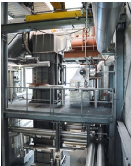
Einblick in die Anlagen zur Wirbelschichtverbrennung
